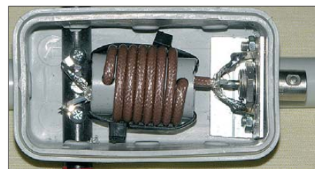
Bild 3: Die neue Speisedrossel weist eine Eigenresonanz von 145 MHz auf.
