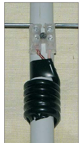
Bild 10: Kontaktierung des Strahlers mit einer Lüsterklemme und direkt auf den Träger gewickelter Koaxialdrossel
